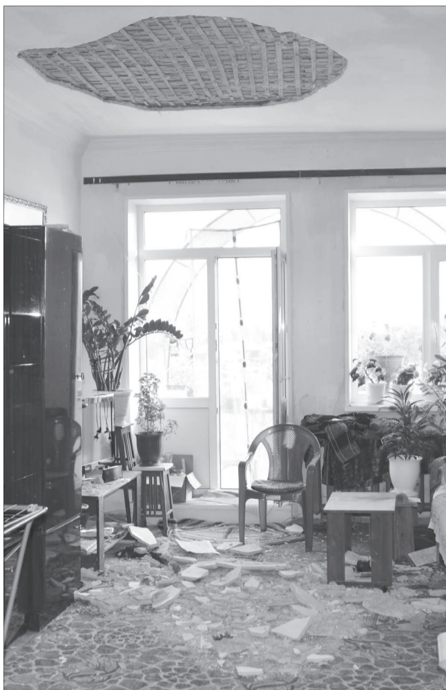
устроили такое «хождение» по потолочным перекрытиям, что по всей штукатурке потолка в квар-
